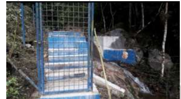
Imagen 2.1.1: Captación de agua Uzhcurrumi
