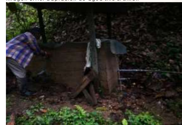
Imagen 2.1.5: Captación de agua sitio El Limón
